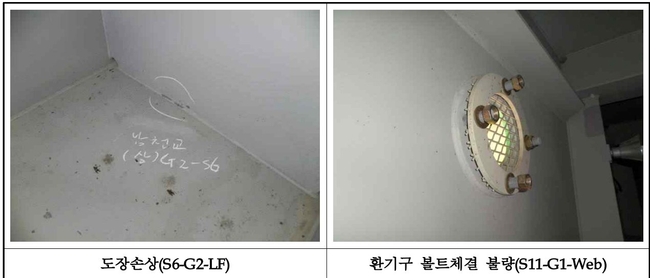
【사진 3.2.4】 강박스 거더 내부 손상현황(대구)
