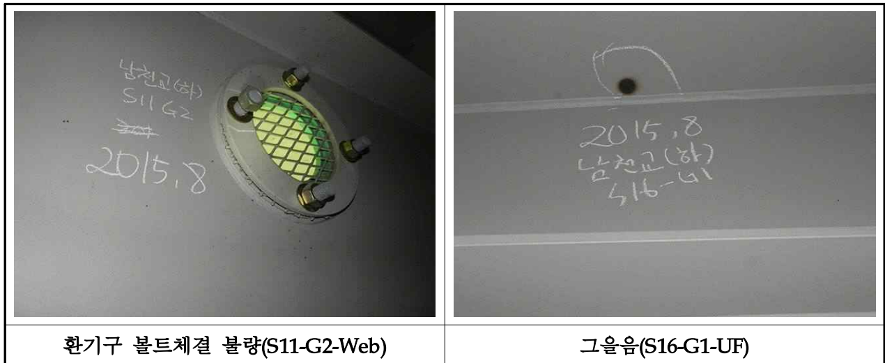
【사진 3.3.4】 강박스 거더 내부 손상현황(부산)
