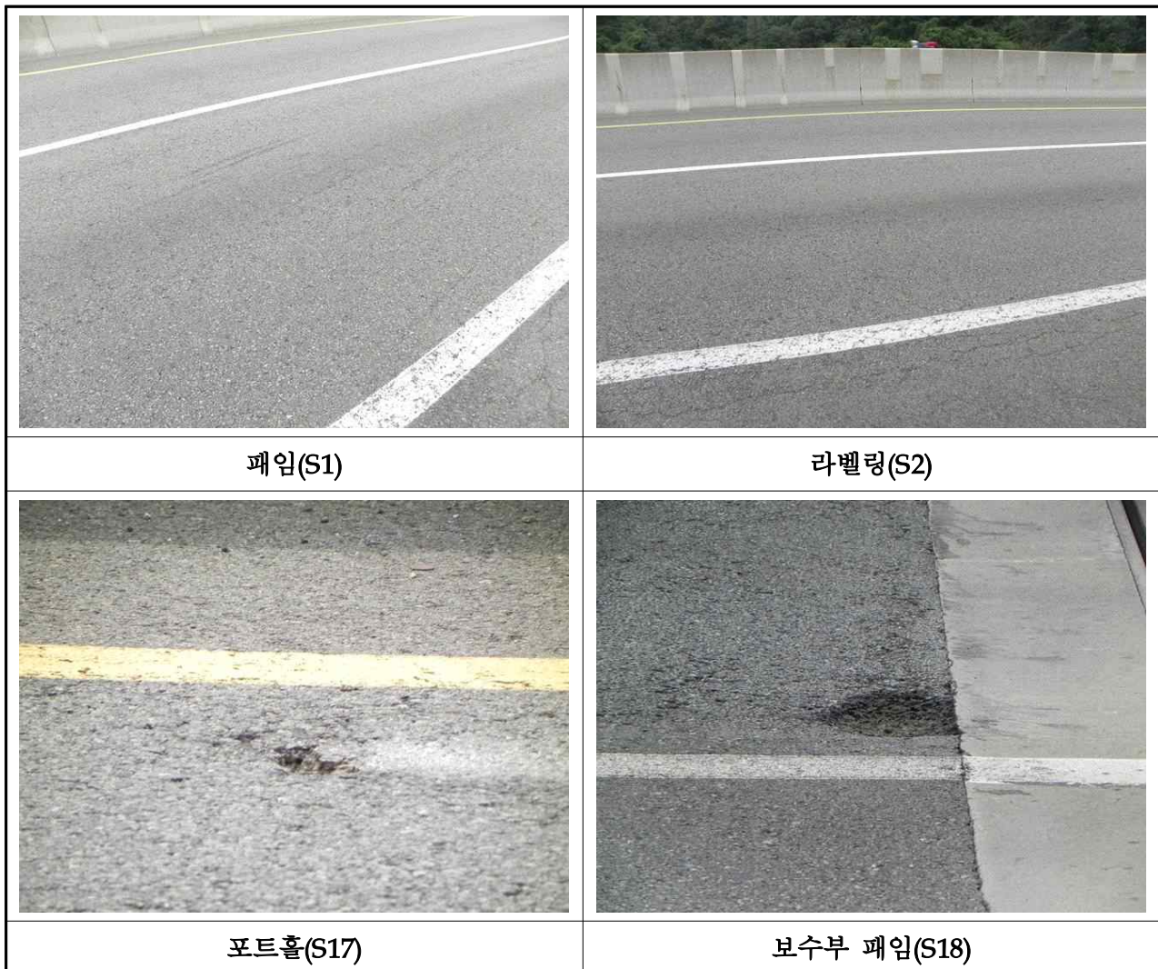
【사진 3.2.21】 교면포장 손상현황(대구)
