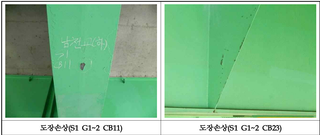
【사진 3.3.7】 가로보 및 세로보 손상현황(부산)
