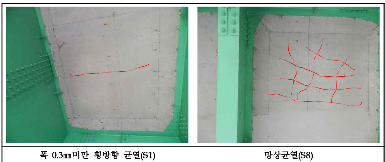
【사진 3.2.2】 바닥판 손상현황(대구)
