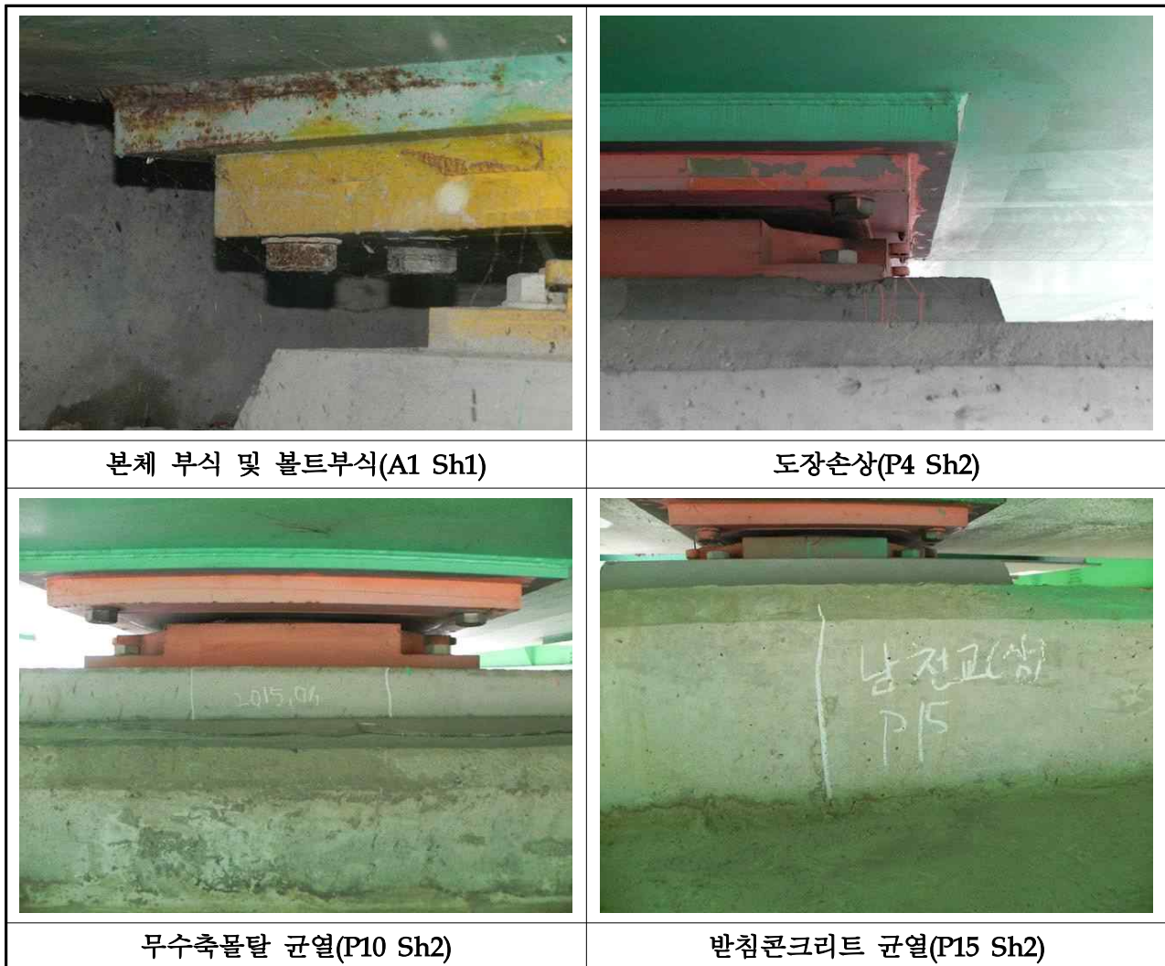
【사진 3.2.14】 교량받침 손상현황(대구)
