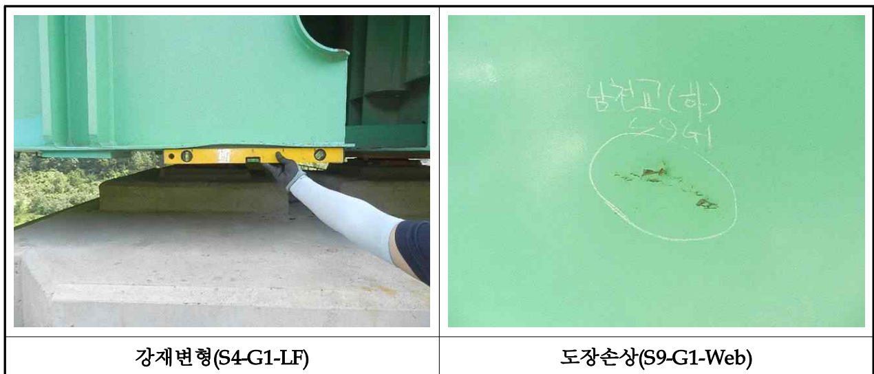
【사진 3.3.5】 강박스 거더 외부 손상현황(부산)
