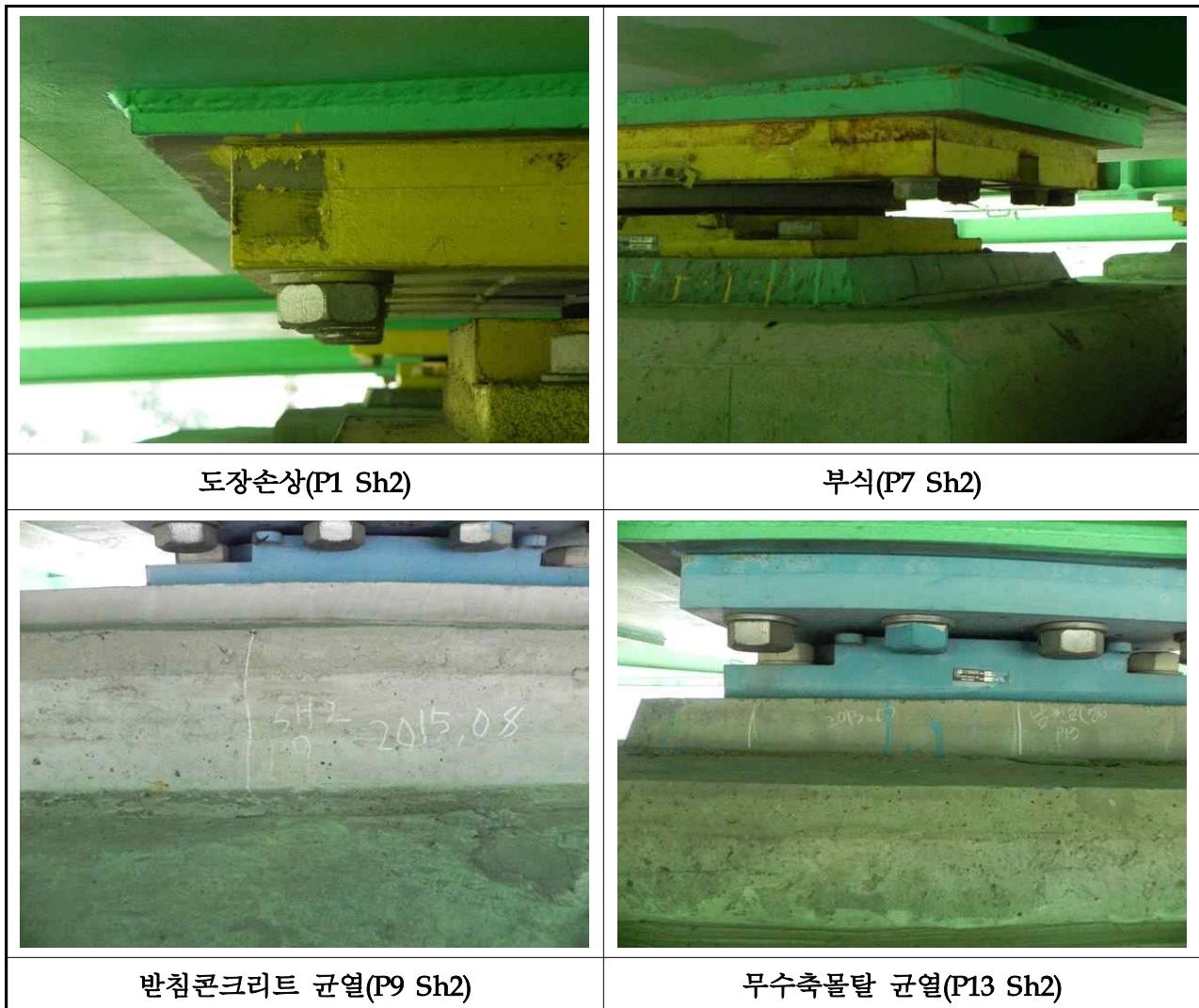
【사진 3.3.15】 교량받침 손상현황(부산)
