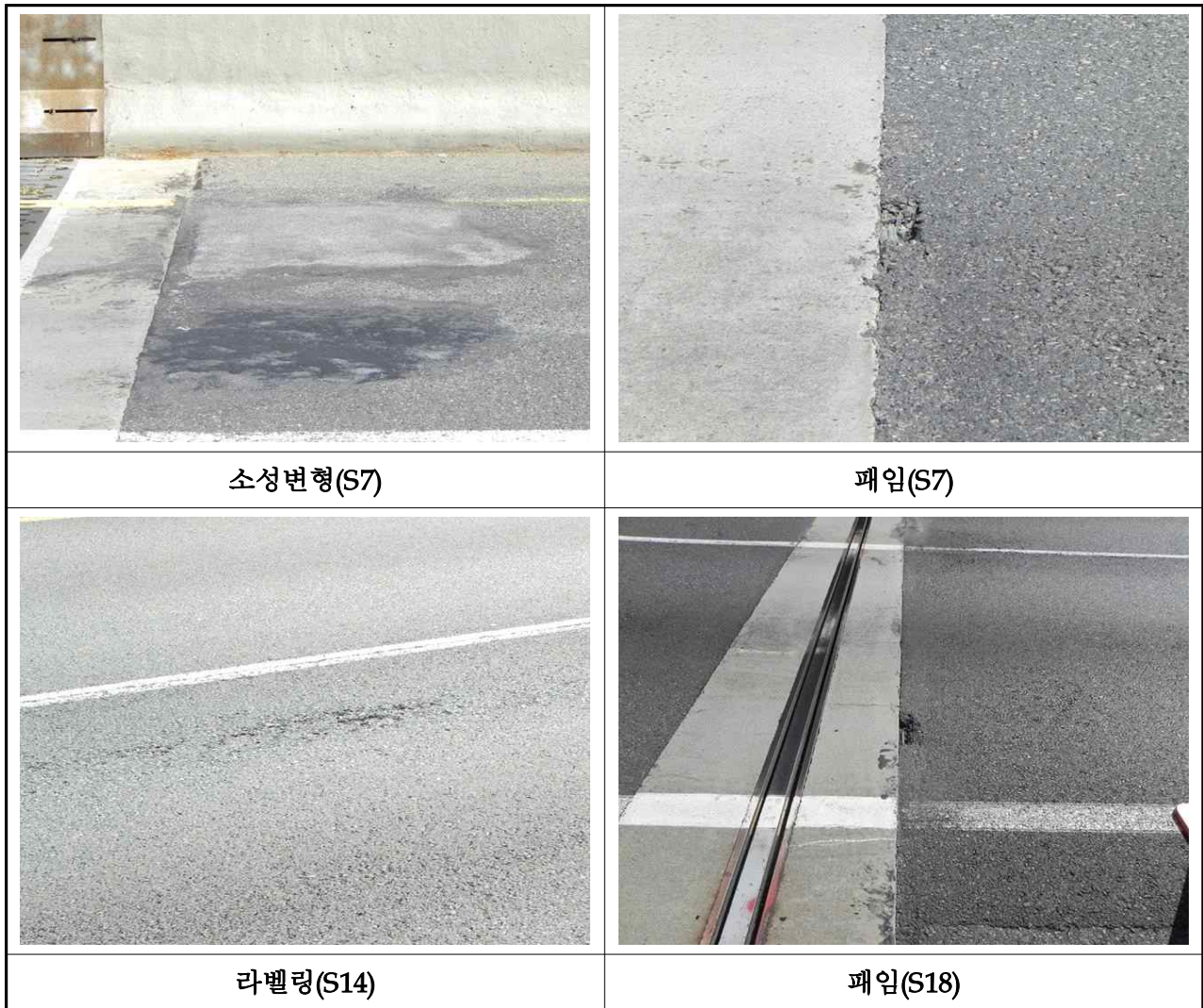
【사진 3.3.22】 교면포장 손상현황(부산)
